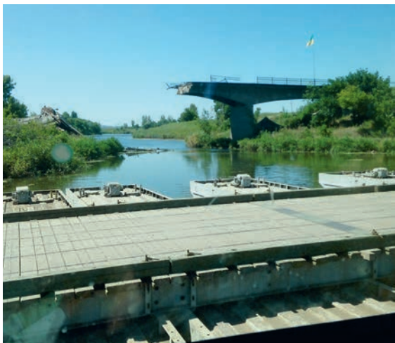
Zerstörte Brücke und seit 2014 prov. Übergang bei Kramatorsk Foto Toni Frisch
