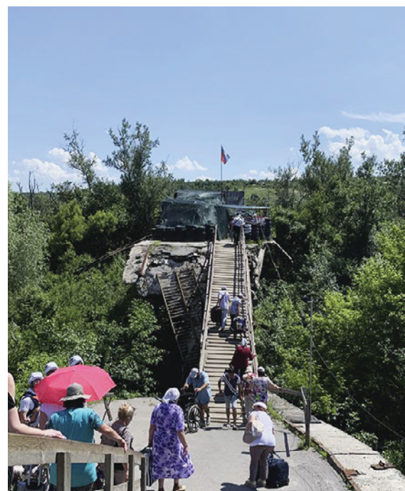
Zerstörte Brücke bei Stanytsia Luhanska Bild OSZE PV
